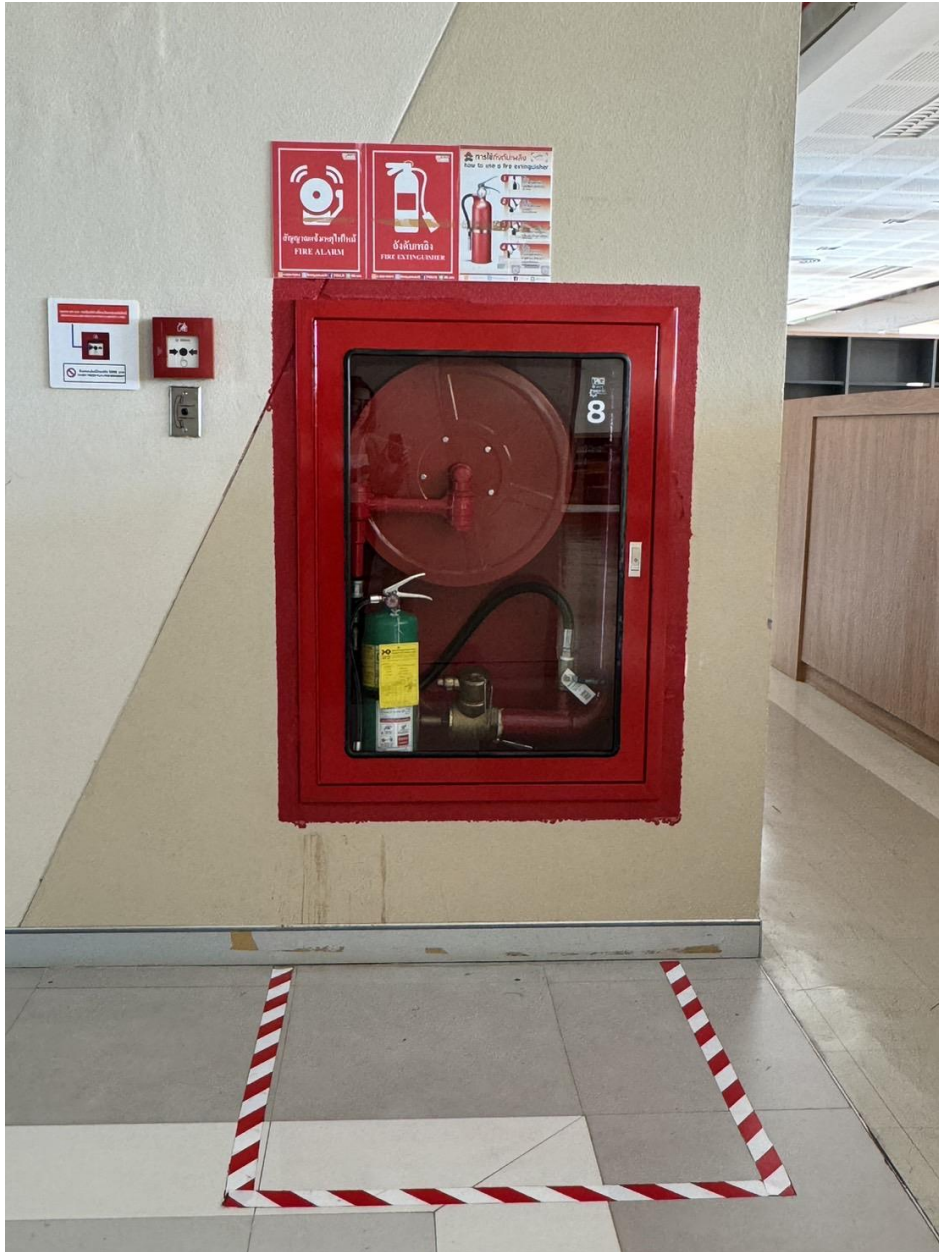
แสดงพื้นที่ตั้งถังดับเพลิง สายดับเพลิงที่ไม่มีสิ่งกีดขวาง
