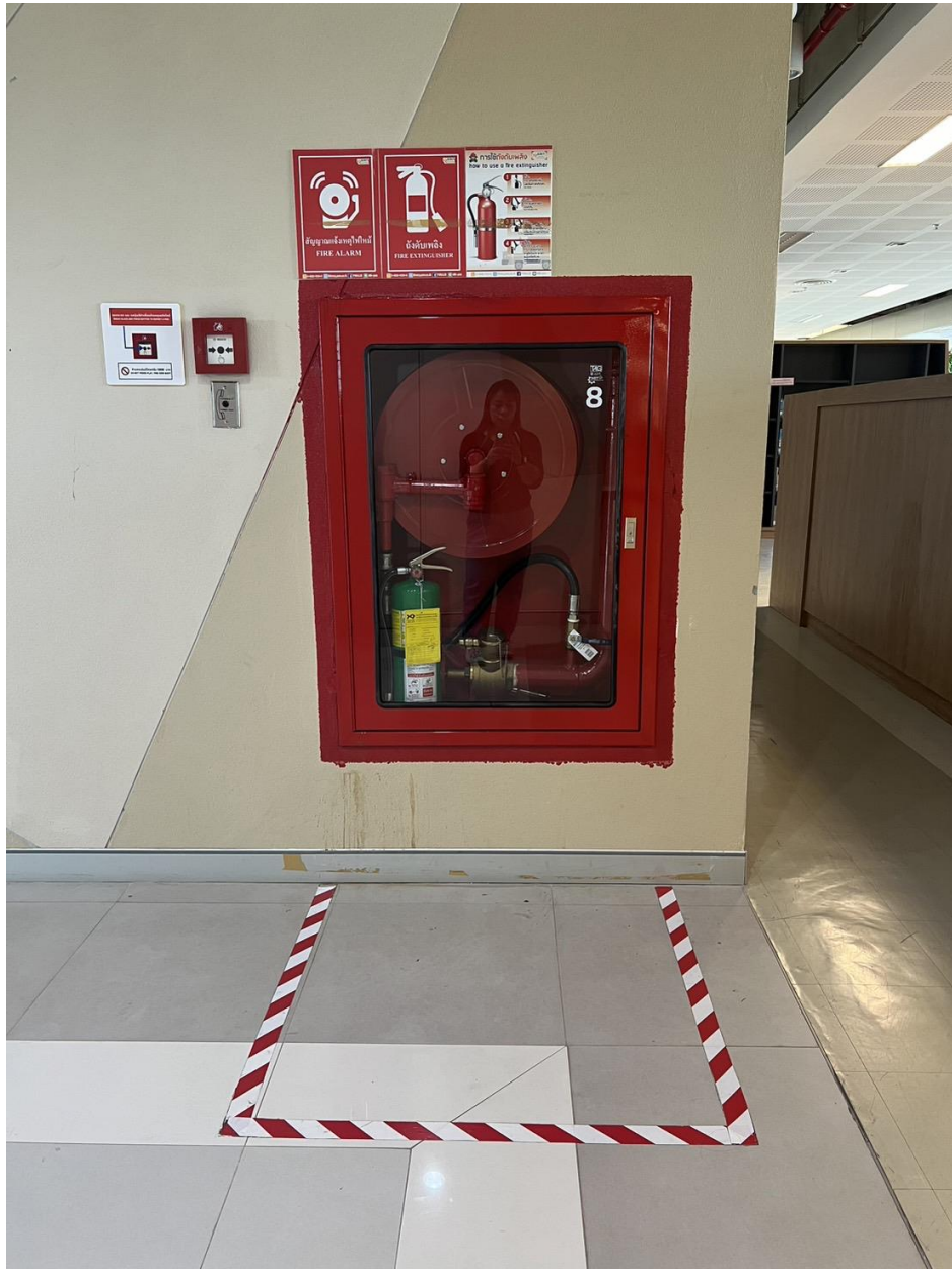
ภาพแสดงที่ตั้งถังดับเพลิง
