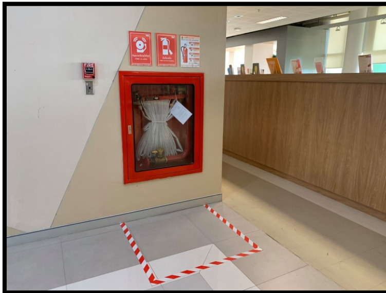
ภาพแสดงที่ตั้งถังดับเพลิง
