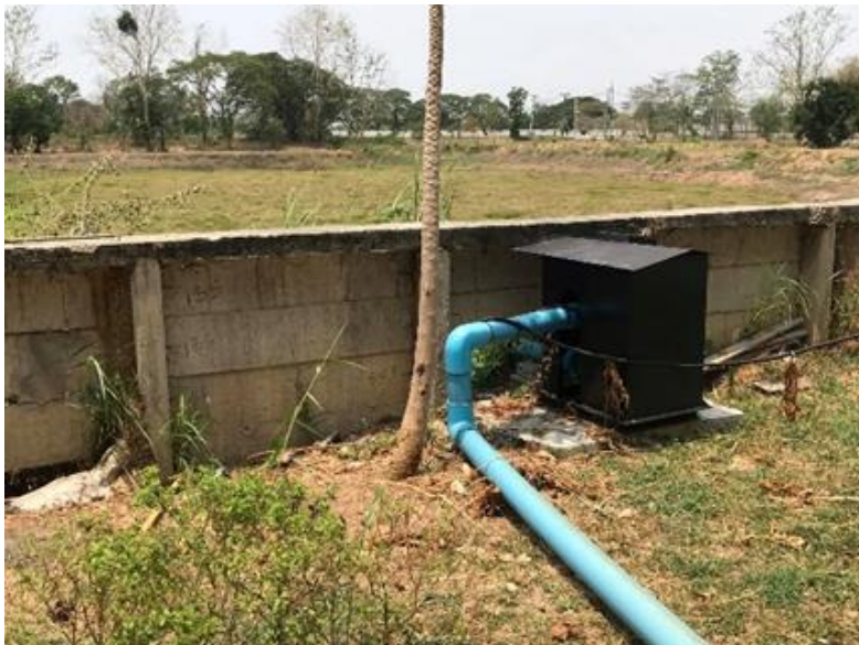
ภาพที่ 9 การบำบัดจากระบบบำบัดน้ำเสียแบบ onsite treatment ของสำนักวิทยบริการฯ จะถูกส่งไปบำบัดในระบบบำบัดน้ำเสียแบบบึงประดิษฐ์ (Constructed Wetland) ของมหาวิทยาลัย ด้านหลังอาคารที่ตั้งของสำนักวิทยบริการฯ
